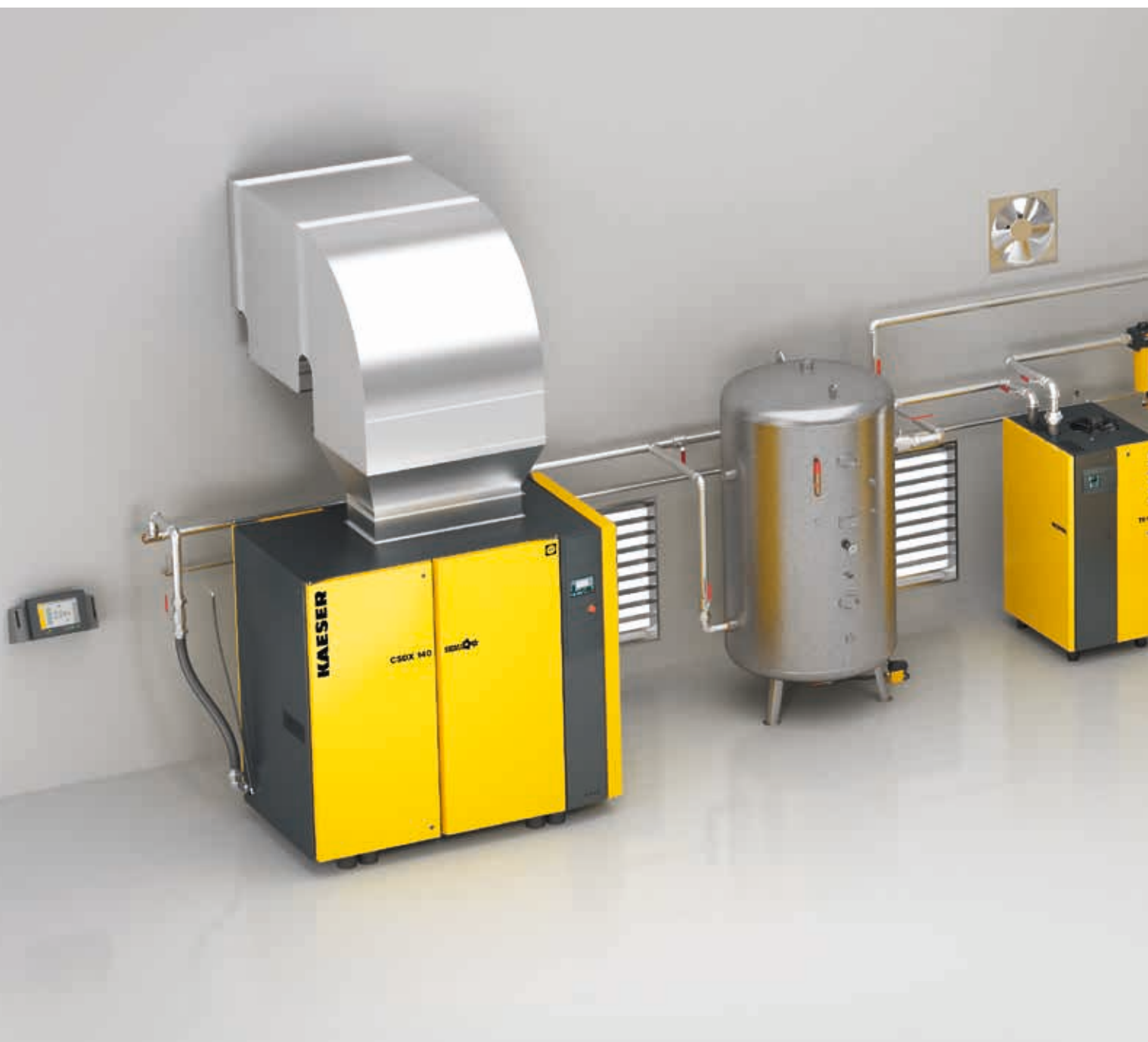
Рис.: Пневмостанция низкого и высокого давления
